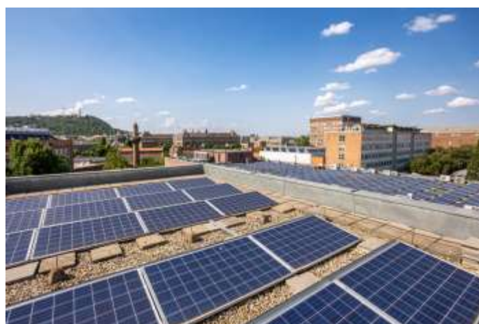
8. ábra: Napelemek a BME épületeinek tetején
